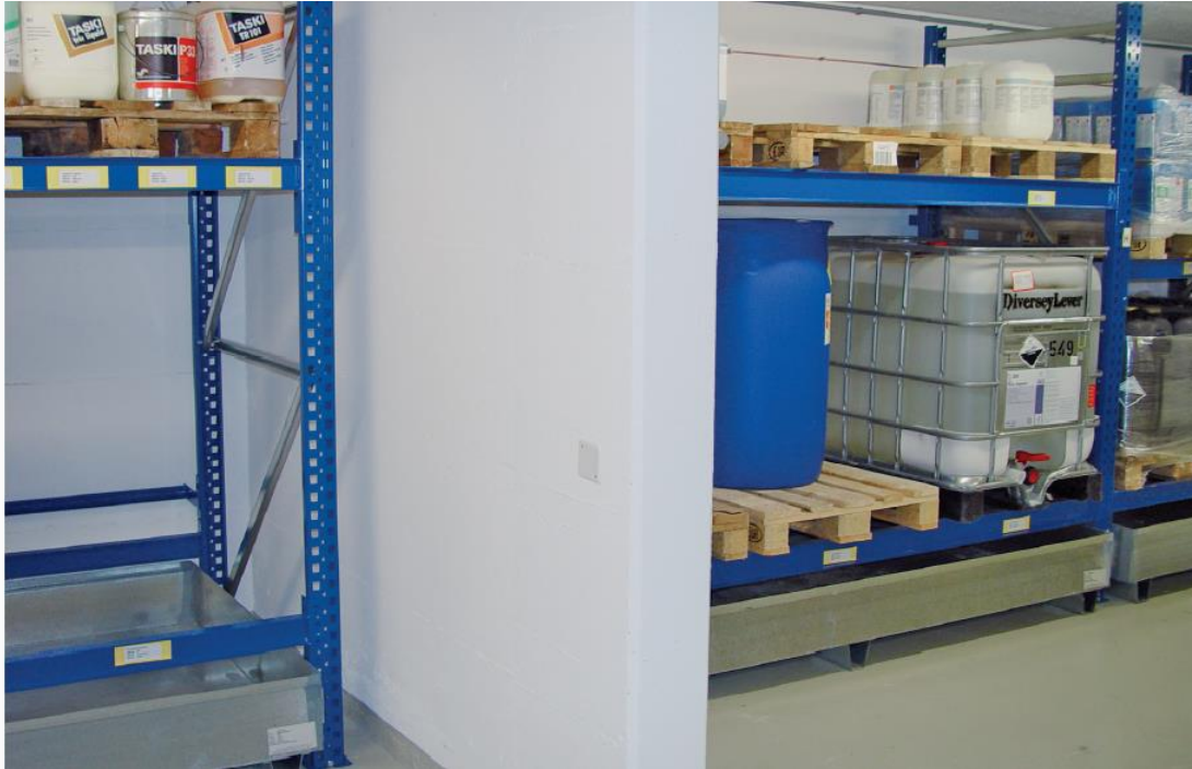
Ejemplo almacenamiento segregado (muro de protección y estanques de retención separados) en la misma sección de incendios
